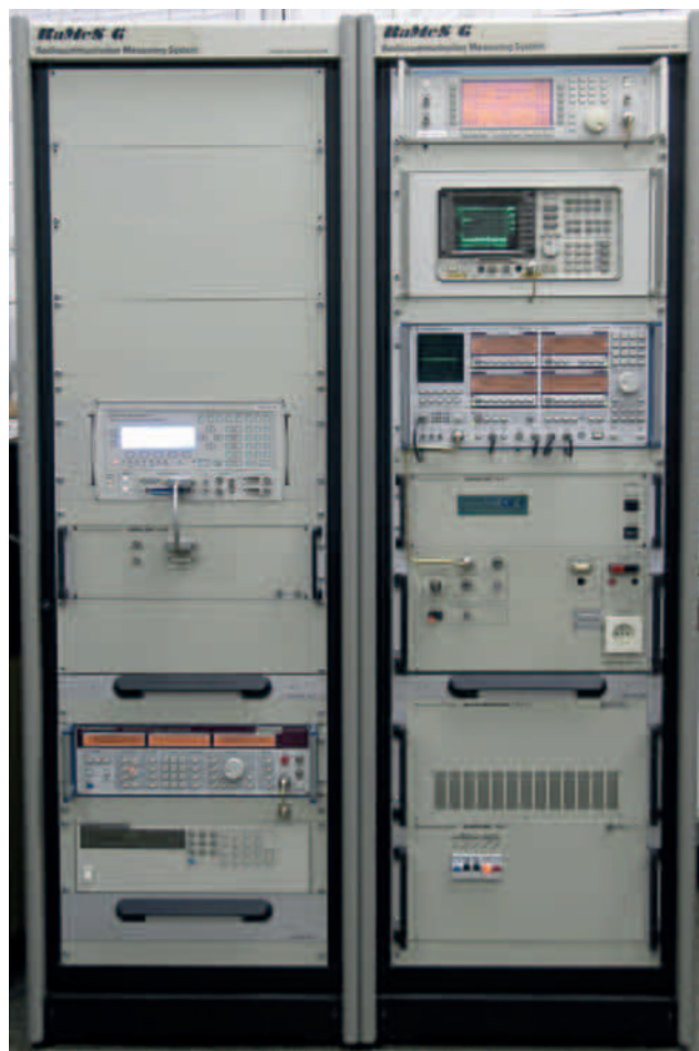
System do pomiarów urządzeń radiokomunikacyjnych FM RaMeS-6 (1995, rozbudowa oprogramowania - 2004)
